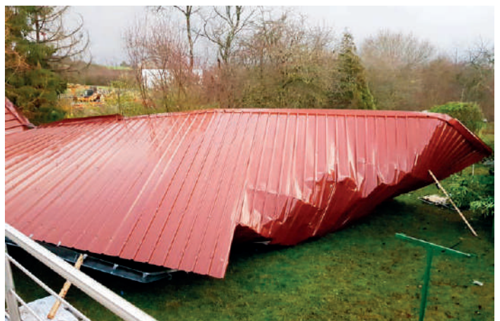
Les toitures d'une rangée de garages arrachées rue d'Etzling
