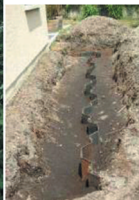
Figure 27 Écran métallique (Source Socabat)
